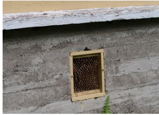
Tuuletusluukku verannan kohdalla.
