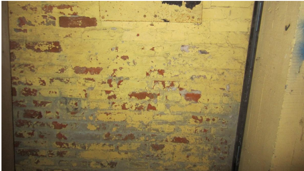
Kuva 11. Mittauspiste MX5. Kannettavalla röntgenfluoresenssispektrometrillä saatujen tulosten perusteella ulkoseinärakenteen pinnassa ei ole merkittävästi kohooneita pitoisuuksia raskasmetalleja. Mittauskorkeus noin 1200 mm lattiatason yläpuolella.
