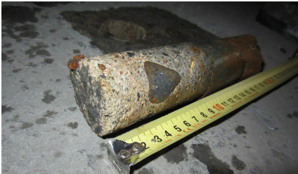
Kuva 20. Näyte PR9. Alapohja. Näyte ~90 mm pinnasta (betoni ~90 mm), näyte katkaistu. Alapohjarakenne näytteenotokohdassa ylhäältäpäin lueteltuna on betoni ~200 mm + sora. Näyte sisältää öljyhiilivetyjä C 10 -C 40 1400 mg/kg.
