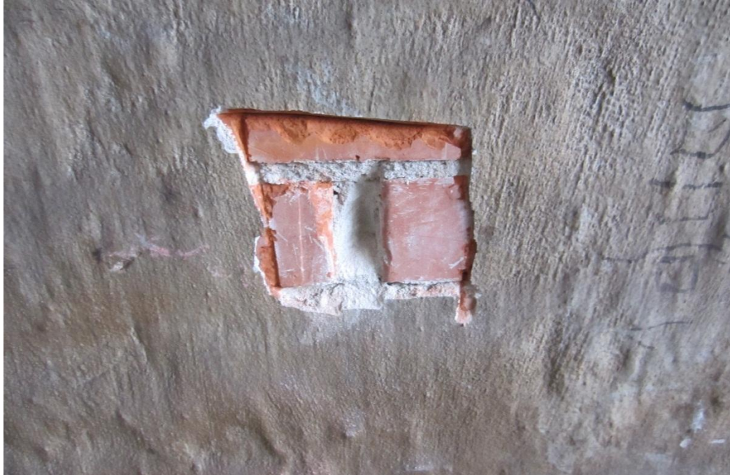
Kuva 5. Näyte PM5. Näyte ulkoseinän sisäpinnan maalista ja rappauksesta noin 15 mm syvyyteen asti. Näyte otettu noin 700 mm lattiatason yläpuolelta. Näytteestä ei analysoitu merkittävästi kohonneita haitta-ainepitoisuuksia.
