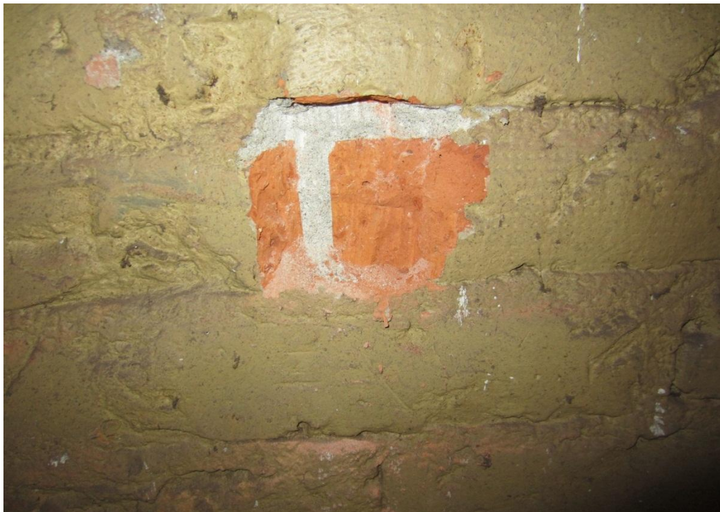
Kuva 6. Näyte PM6. Näyte ulkoseinän sisäpinnan maalista, tiilestä ja saumalaastista noin 20 mm syvyyteen. Näyte otettu noin 400 mm lattiatason yläpuolelta. Näytteestä ei analysoitu merkittävästi kohonneita haitta-ainepitoisuuksia.
