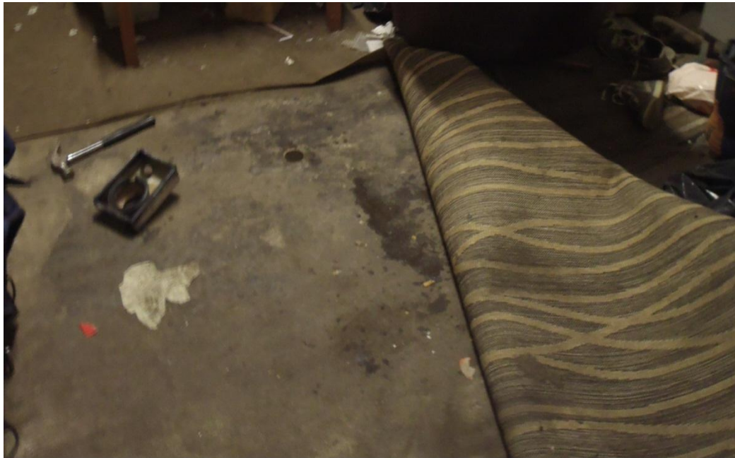
Kuva 33. Näyte PS2. Alapohja. Näyte ~75 mm yläpinnasta (betoni ~75 mm), näyte katkaistu, pinnassa oleva tumma ja pehmeä materiaali poistettu ennen analysointia. Alapohjarakenne näytteenottokohdassa ei selvinnyt porauksen päätyttyä. Näyte sisältää öljyhiilivetyjä C 10 -C 40 210 mg/kg.
