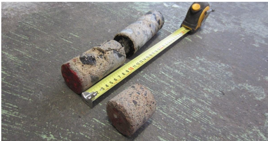
Kuva 28. Näyte PR17. Alapohja. Näyte ~100 mm vanhan betonilaatan pinnasta (punainen maali + betoni ~100 mm), näyte katkaistu (ylemmästä osasta näyte PR16). Alapohjarakenne näytteenottokohdassa ylhäältäpäin lueteltuna on harmaa maali + betoni ~50 mm + punainen maali + betoni ~100 mm + kosteudensulkusively + betoni ~140 mm + sora. Näytteestä ei analysoitu merkittävästi kohonneita haitta-ainepitoisuuksia
