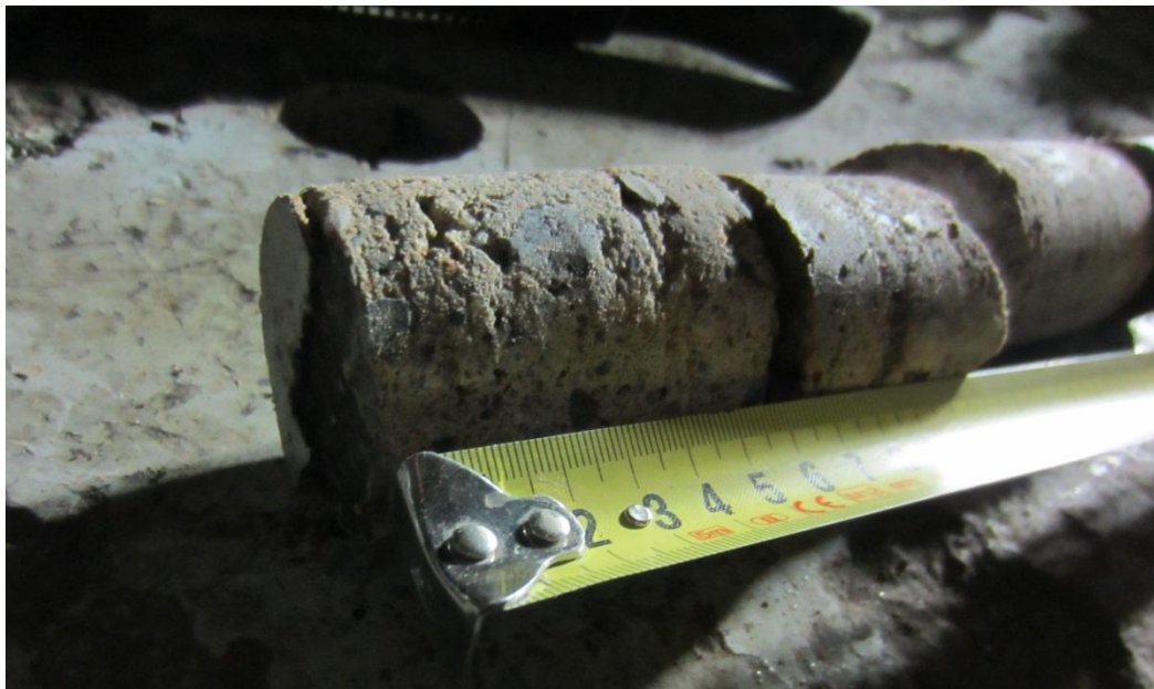
Kuva 16. Näyte PR5. Alapohja. Näyte ~95 mm pinnasta (harmaa maali + betoni ~60 mm + tasoite ~15 mm + betoni 20 mm), näyte katkaistu. Alapohjarakenne näytteenottokohdassa ei selvinnyt porauksen päätyttyä. Näyte sisältää öljyhiilivetyjä C 10 -C 40 2500 mg/kg.
