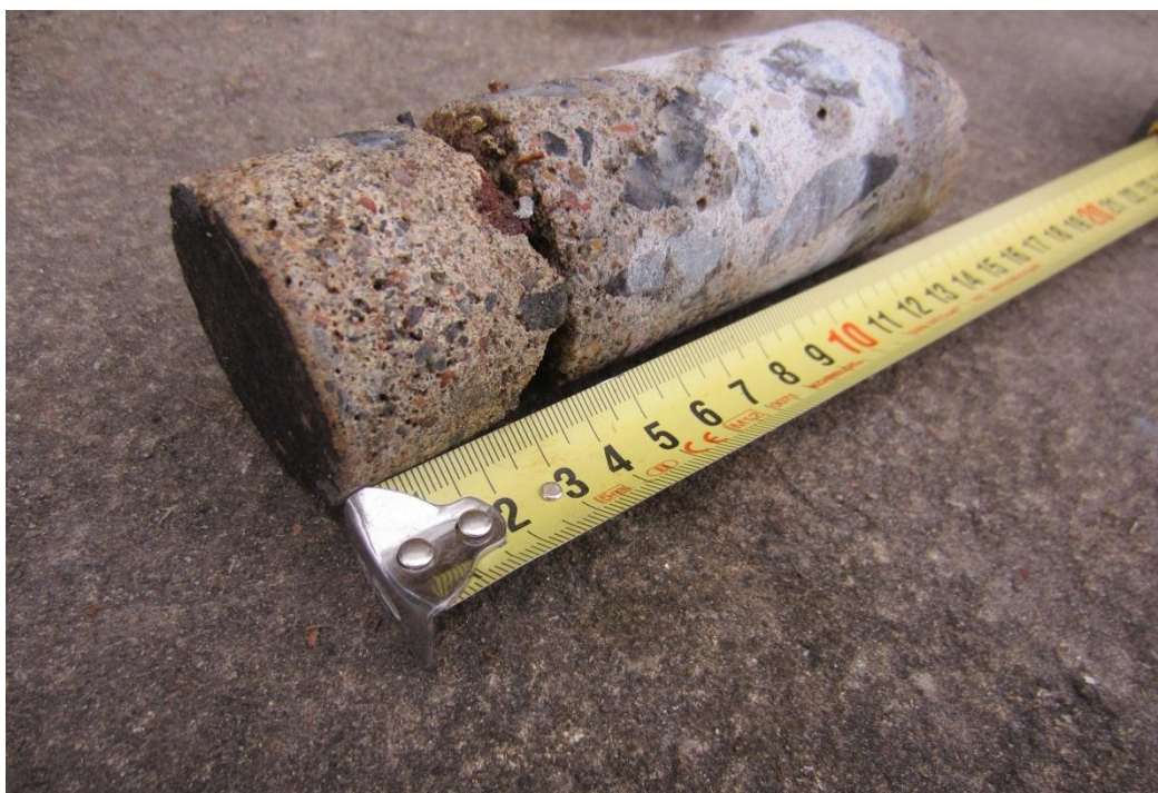
Kuva 26. Näyte PR15. Alapohja. Näyte ~135 mm pinnasta (tumma maali + betoni ~35 mm + betoni ~100 mm), näyte katkaistu. Alapohjarakenne näytteenottokohdassa ei selvinnyt porauksen päätyttyä. Näyte sisältää öljyhiilivetyjä C 10 -C 40 440 mg/kg.
