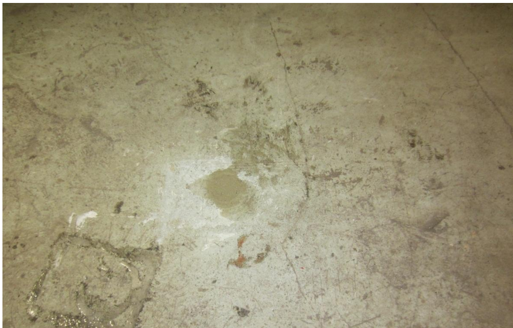
Kuva 12. Näyte PR1. Välipohja. Näyte ~42 mm yläpinnasta (vihreä maali + tasoite ~12 mm + betoni ~30 mm), näyte katkaistu. Välipohjarakenne näytteenottokohdassa ei selvinnyt porauksen päätyttyä. Näyte sisältää öljyhiilivetyjä C 10 -C 40 550 mg/kg.
