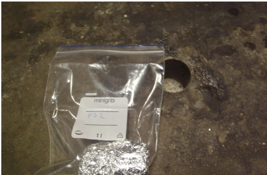
Kuva 32. Näyte PS1. Välipohja. Näyte ~80 mm yläpinnasta (betoni ~80 mm), näyte katkaistu, pinnassa oleva "tumma möhnä" poistettu. Välipohjarakenne näytteenottokohdassa ei selvinnyt porauksen päätyttyä. Näyte sisältää öljyhiilivetyjä C 10 -C 40 610 mg/kg.
