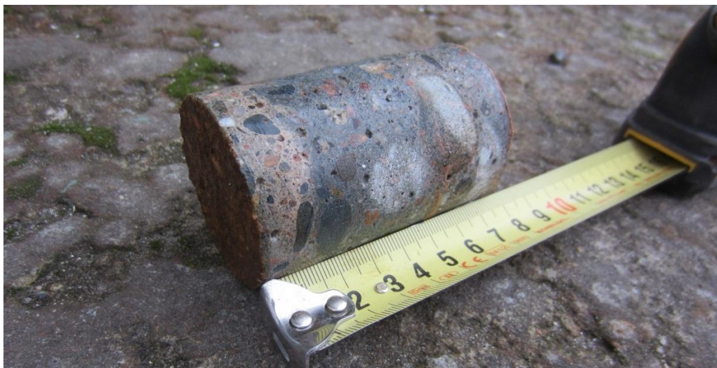
Kuva 24. Näyte PR13. Alapohja. Näyte ~75 mm pinnasta (betoni ~75 mm), näyte katkaistu. Alapohjarakenne näytteenottokohdassa ei selvinnyt porauksen päätyttyä. Näyte sisältää öljyhiilivetyjä C 10 -C 40 1000 mg/kg.
