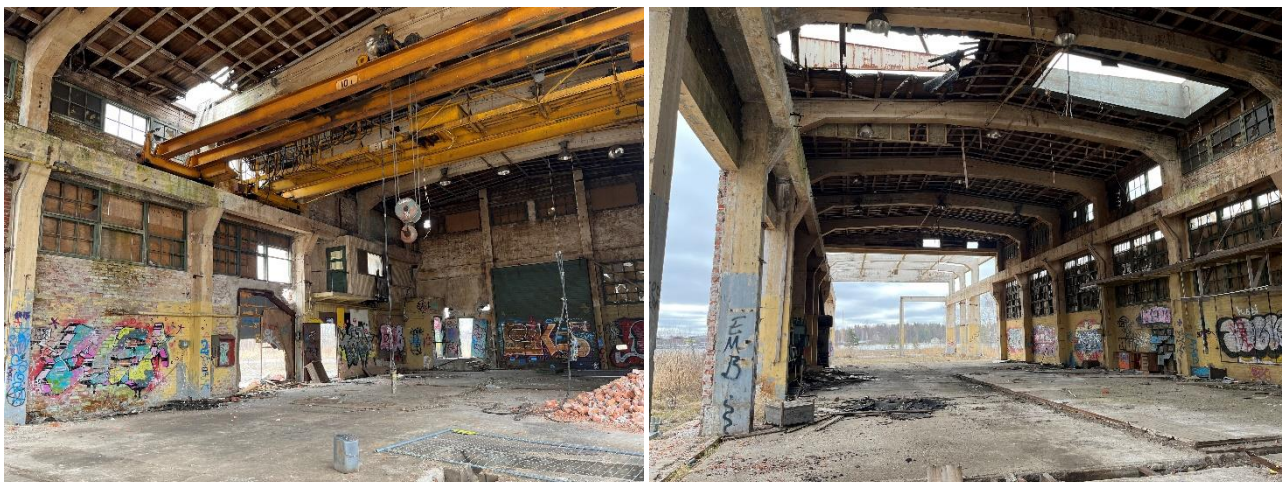
Bild Köpeobjektet kräver omfattande sanerings- och renoveringsarbete. 2023.
