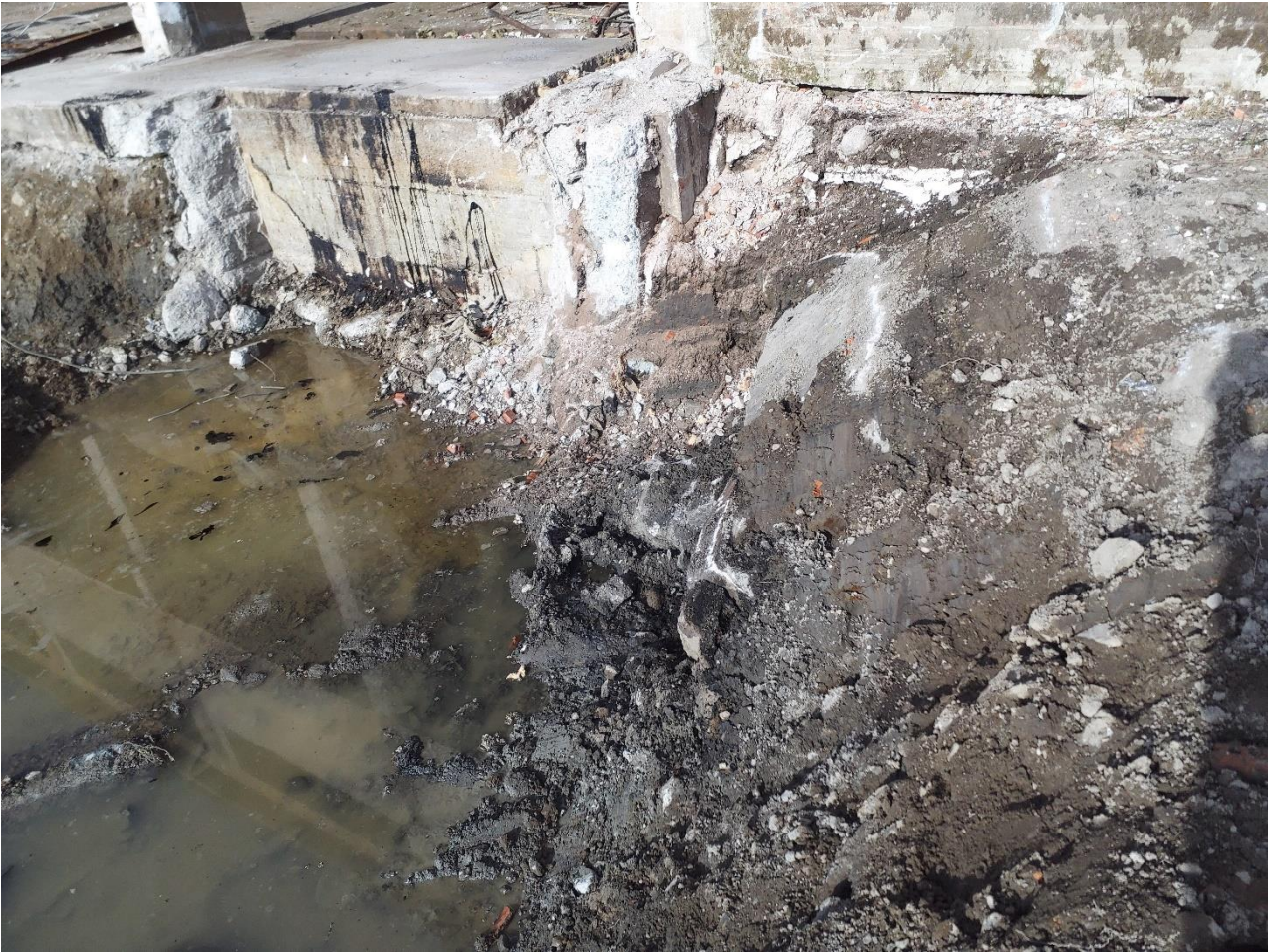
Kuva 4-1. Poistettujen öljysäiliöiden kaivanto rakennuksen itäpuolella 4.5.2021. Kaivantoon jäi öljypitoista maata, koska kallio tuli vastaan eikä näin ollen syvemmälle päässyt.
