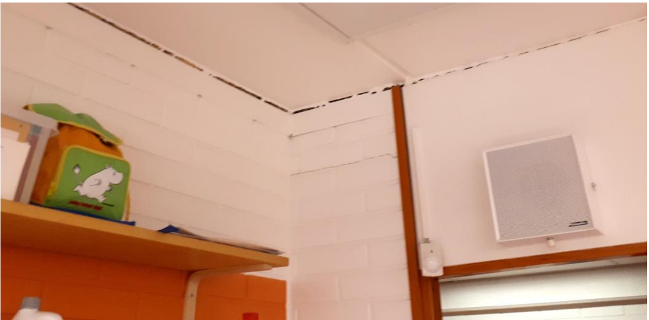
Kuva 24. Painumisesta aiheutuneita halkeamia seinässä. (Lähde: Vaasan kaupunki ja Vahanen Rakennusfysiikka Oy 2018)
