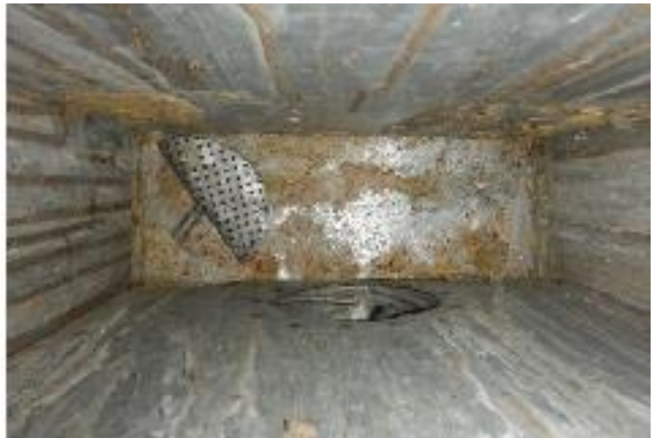
Kuva 27. Ilmastointikanavat ovat likaisia ja kuluneita. (Lähde: Vaasan kaupunki ja Vahanen Rakennusfysiikka Oy 2018)
