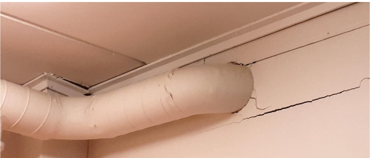
Kuva 25. Painumisesta aiheutuneita halkeamia seinässä. (Lähde: Vaasan kaupunki ja Vahanen Rakennusfysiikka Oy 2018)
