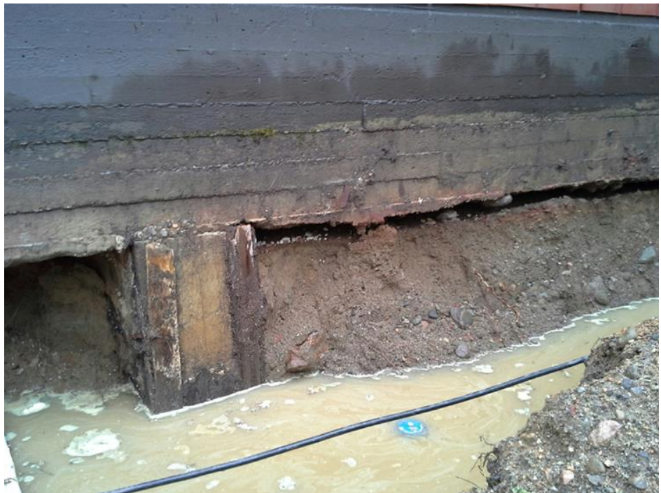
Kuva 23. Päiväkodin lattian painumia. (Lähde: Vaasan kaupunki ja Vahanen Rakennusfysiikka Oy 2018)
