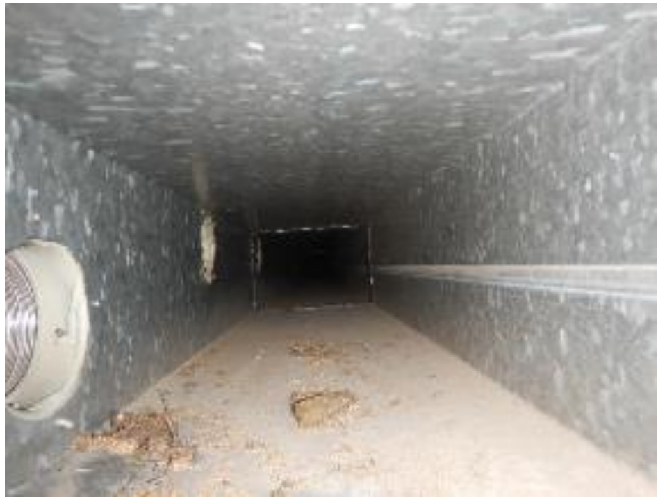
Kuva 26. Ilmastointikanavissa on mineraalivillan paloja. (Lähde: Vaasan kaupunki ja Vahanen Rakennusfysiikka Oy 2018)
