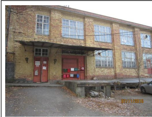
Kuva 23. Itäpuolen julkisivua. Vetotangoihin vahvistettu kevyt lippa. Rikkoutunut lastauslaituri.
