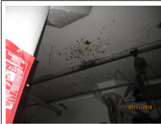
Kuva 11. Rakennuksen välipohjissa puskee öljyt paikka paikoin läpi.
