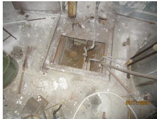
Kuva 14. Kellarin lattiassa on suojaamattomia aukkoja.
