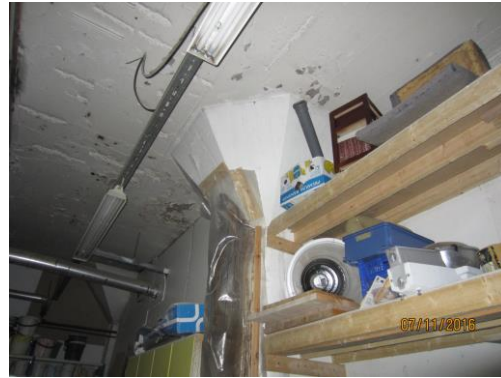
Kuva 12. Vanha vuotava sadevesiputki teipattu 1. kerroksessa.
