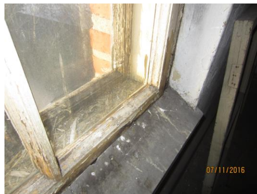
Kuva 16. Ikkunat kiinteistössä ovat käyttökänsä päässä.
