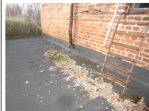
Kuva 7. Torniosan julkisivumuurausta tippuu vesikatolle. Korjattua ja vanhaa vesikattopintaa. Torniosan vesikatolle ei päästy.
