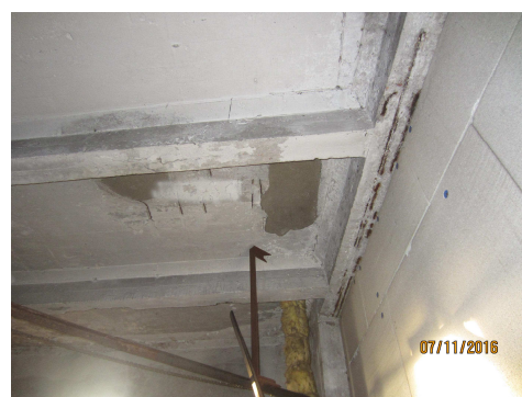
Kuva 10. Torniosan vesikatto vuotanut ja kattopalkit vaurioituneet.
