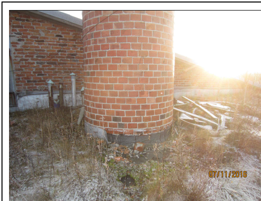
Kuva 5. Vesikatolla vuotava piipun juuri ja muita läpimenoja.
