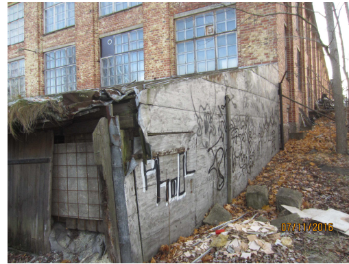
Kuva 24. Pohjoispuolen rikkoutunutta matalaa varastoa nk. "Kinamuren".
