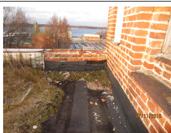
Kuva 6. Vesikatolla on runsaasti puuttuvia ja rikkoutuneita räystääspeltejä. Torniosan muurauksia tippunut alemmalle tasolle. Korjattua ja vanhaa vesikattopin- taa.
