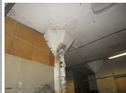
Kuva 9. 1. kerroksen katossa kattovesiputket vuotavat joka paikassa. Rikkinäiset asbestieristeet.
