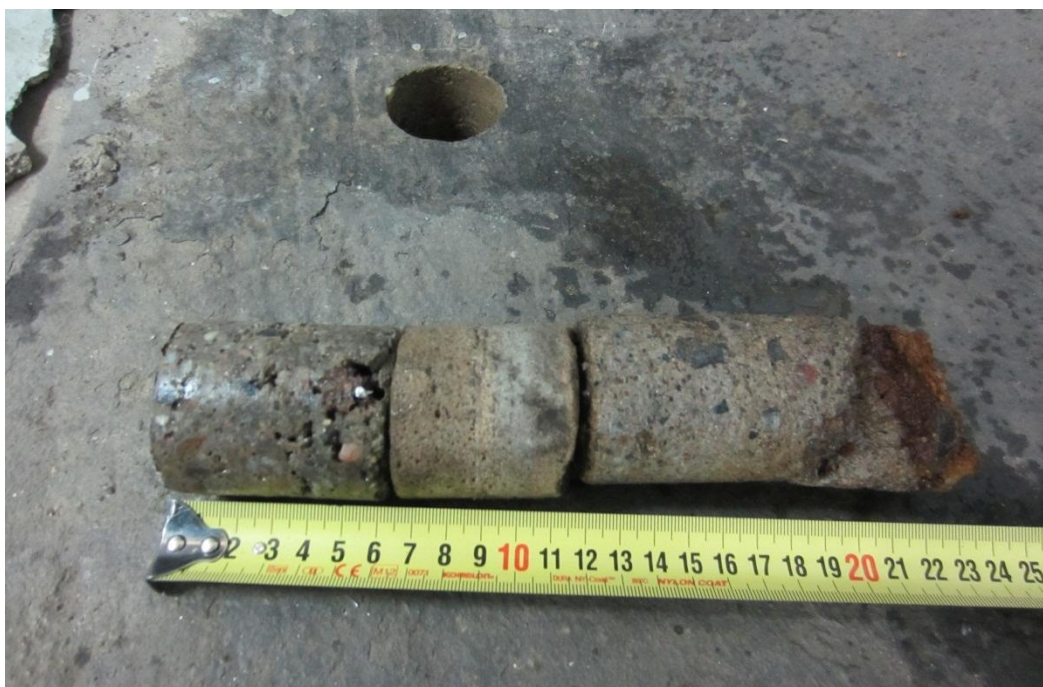
Kuva 14. Näyte PR3. Alapohja. Näyte ~60 mm pinnasta (betoni), näyte katkaistu. Alapohjarakenne näytteenottokohdassa ylhäältäpäin lueteltuna on betoni ~60 mm + betoni ~50 mm + kosteudensulkusively + betoni ~100 mm + sora. Näyte sisältää öljyhiilivetyjä C_{10} - C_{40} 1800 mg/kg.
