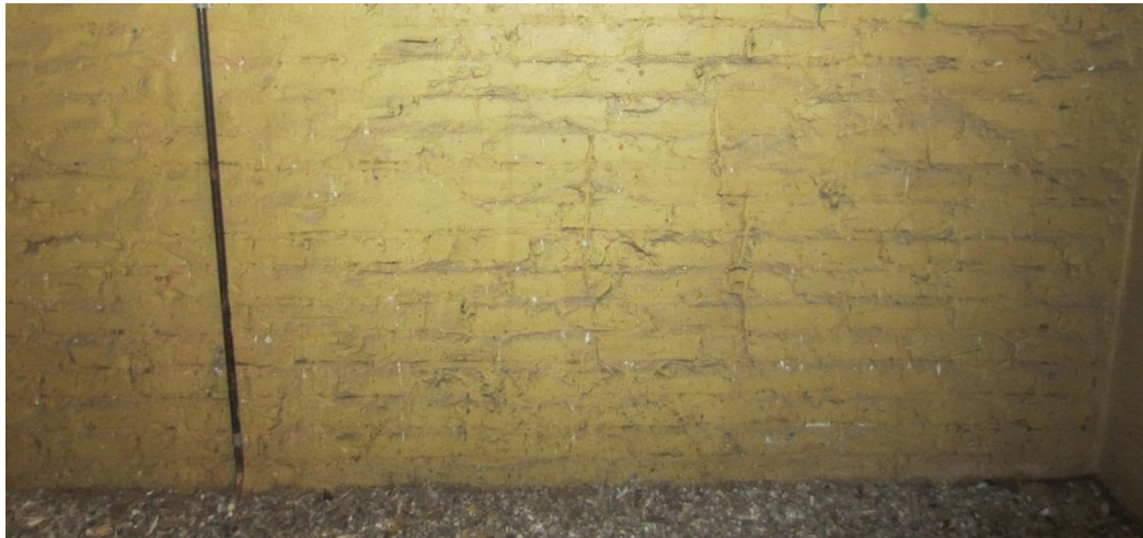
Kuva 7. Mittauspiste MX1. Kannettavalla röntgenfluoresenssispektrometrillä saatujen tulosten perusteella ulkoseinärakenteen pinnassa ei ole merkittävästi kohonneita pitoisuuksia raskasmetalleja. Mittauskorkeus noin 1200 mm lattiatason yläpuolella.
