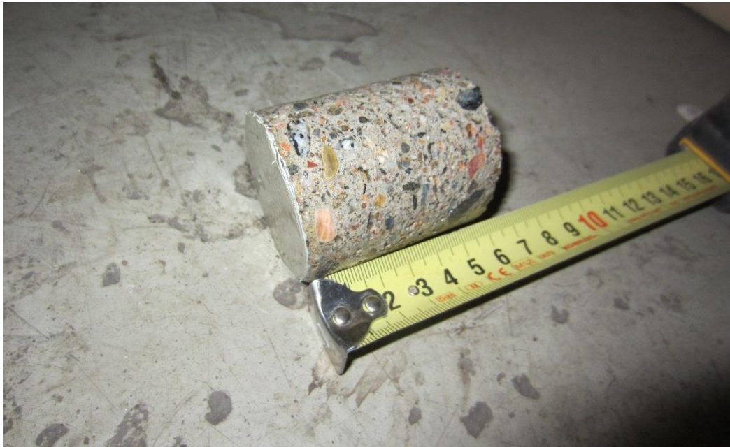
Kuva 31. Näyte PR20. Välipohja. Näyte ~60 mm yläpinnasta (vaalean vihreä maali + betoni ~60 mm), näyte katkaistu. Välipohjarakenne näytteenottokohdassa ei selvinnyt porauksen päätyttyä. Näyte sisältää öljyhiihivetyjä C 10 -C 40 250 mg/kg.
