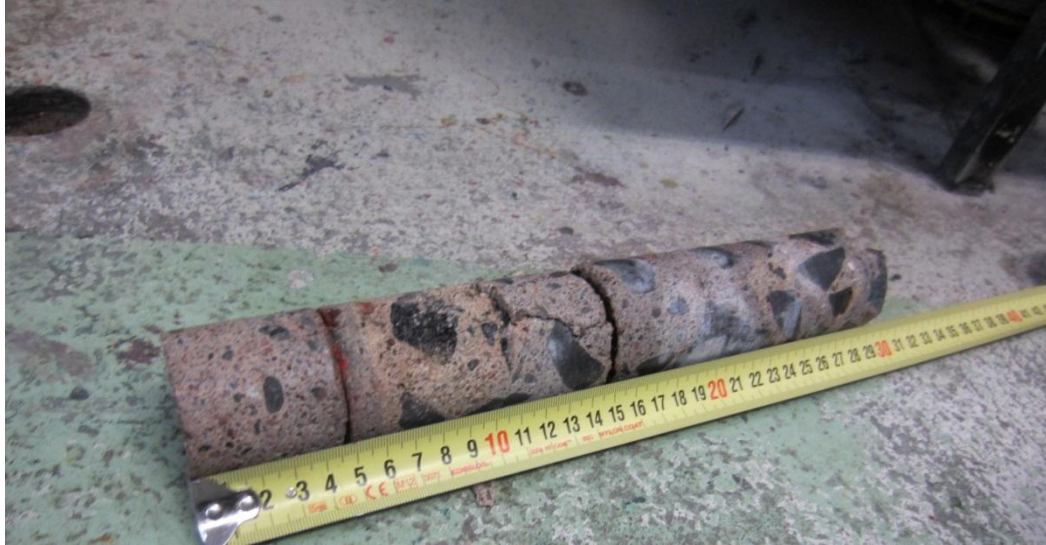
Kuva 27. Näyte PR16. Alapohja. Näyte ~50 mm pinnasta (harmaa maali + betoni ~50 mm), näyte katkaistu (alemmasta osasta näyte PR17). Alapohjarakenne näytteenottokohdassa ylhäältäpäin lueteltuna on harmaa maali + betoni ~50 mm + punainen maali + betoni ~100 mm + kosteudensulkusively + betoni ~140 mm + sora. Näytteestä ei analysoitu merkittävästi kohonneita haitta-ainepitoisuuksia.
