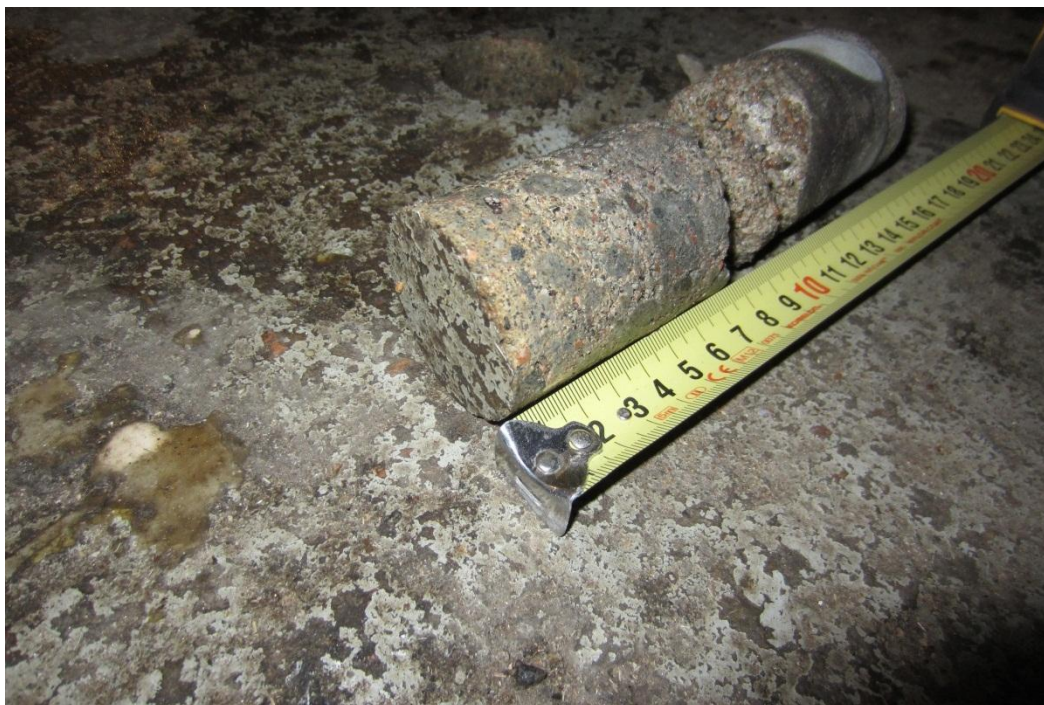
Kuva 18. Näyte PR7. Alapohja. Näyte ~70 mm pinnasta (harmaa maali + betoni ~70 mm), näyte katkaistu. Alapohjarakenne näytteenottokohdassa ylhäältäpäin lueteltuna on harmaa maali + betoni ~200 mm + sora. Näyte sisältää öljyhiilivetyjä C 10 -C 40 2500 mg/kg.
