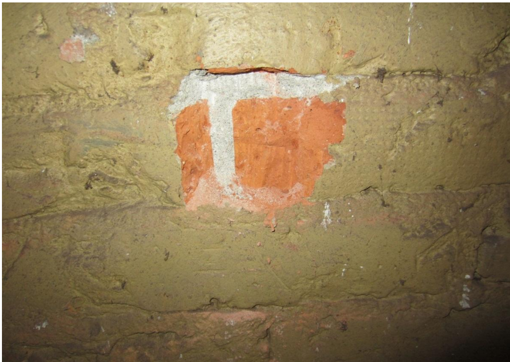
Kuva 6. Näyte PM6. Näyte ulkoseinän sisäpinnan maalista, tiilestä ja saumalaastista noin 20 mm syvyyteen. Näyte otettu noin 400 mm lattiatason yläpuolelta. Näytteestä ei analysoitu merkittävästi kohonneita haitta-ainepitoisuuksia.
