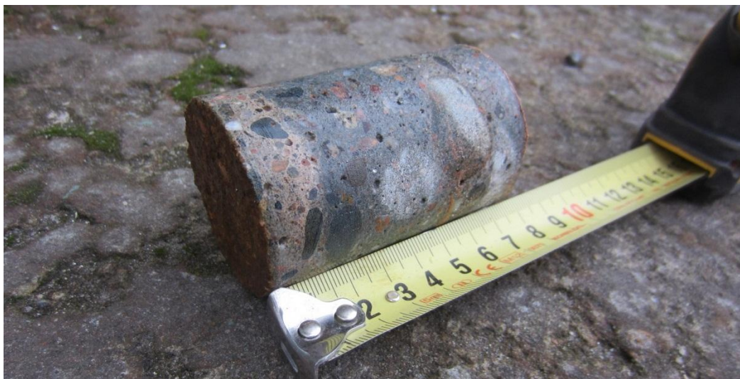
Kuva 24. Näyte PR13. Alapohja. Näyte ~75 mm pinnasta (betoni ~75 mm), näyte katkaistu. Alapohjarakenne näytteenottokohdassa ei selvinnyt porauksen päätyttyä. Näyte sisältää öljyhiilivetyjä C 10 -C 40 1000 mg/kg.
