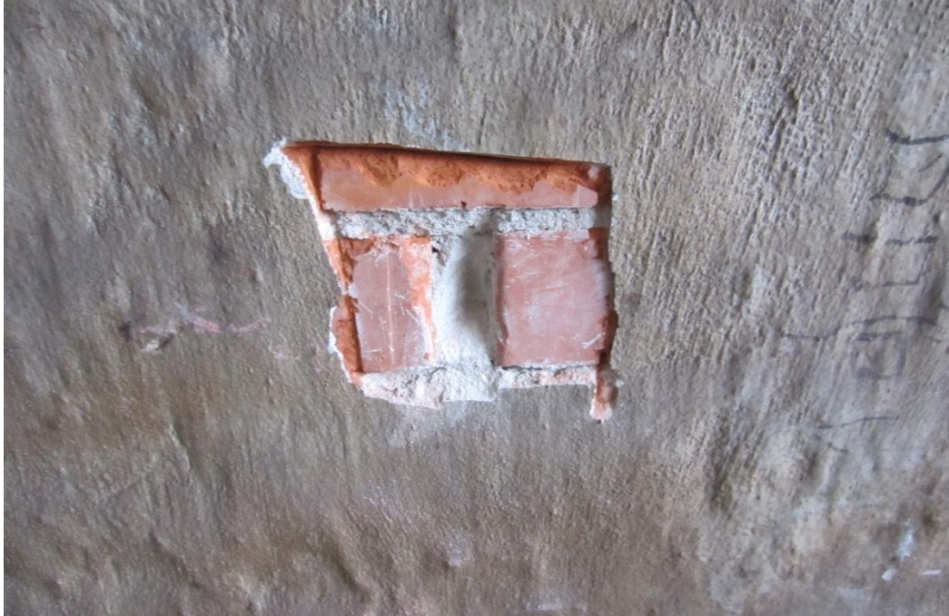
Kuva 5. Näyte PM5. Näyte ulkoseinän sisäpinnan maalista ja rappauksesta noin 15 mm syvyyteen asti. Näyte otettu noin 700 mm lattiatason yläpuolelta. Näytteestä ei analysoitu merkittävästi kohonneita haitta-ainepitoisuuksia.
