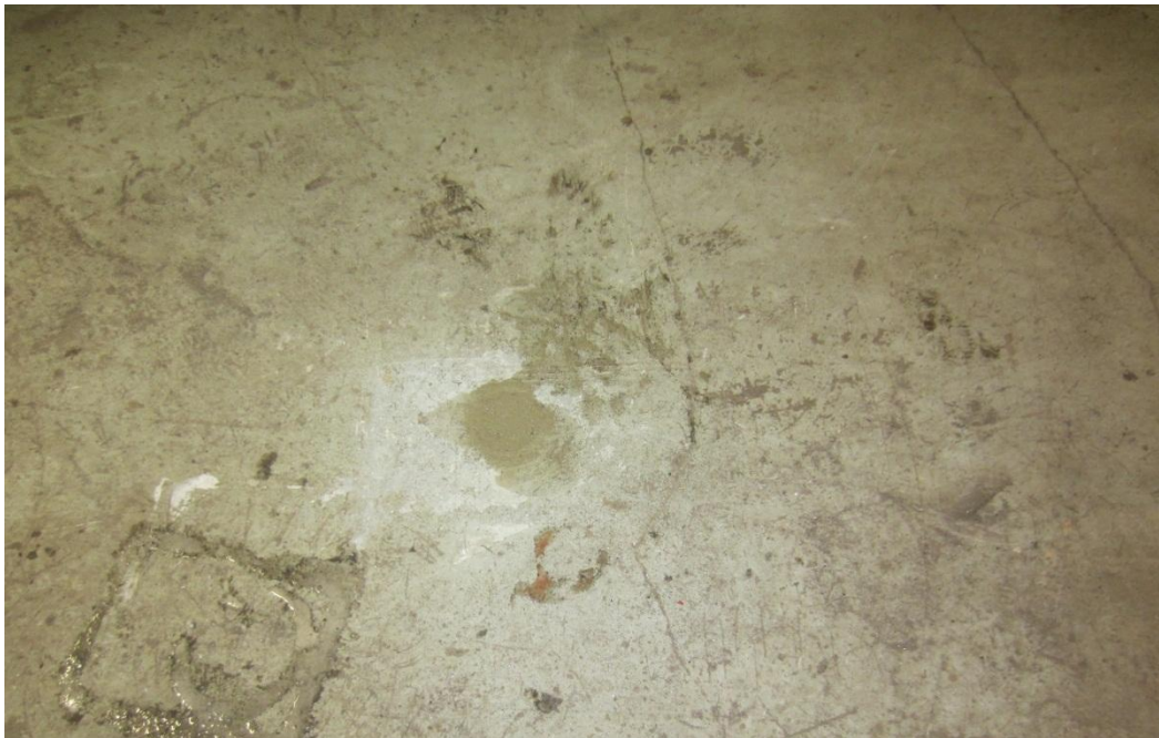
Kuva 12. Näyte PR1. Välipohja. Näyte ~42 mm yläpinnasta (vihreä maali + tasoite ~12 mm + betoni ~30 mm), näyte katkaistu. Välipohjarakenne näytteenottokohdassa ei selvinnyt porauksen päätyttyä. Näyte sisältää öljyhiilivetyjä C 10 -C 40 550 mg/kg.
