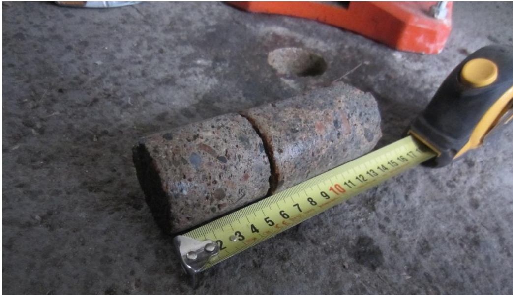
Kuva 21. Näyte PR10. Alapohja. Näyte ~145 mm pinnasta (betoni ~55 mm + betoni ~90 mm), näyte katkaistu. Alapohjarakenne näytteenottokohdassa ei selvinnyt porauksen päätyttyä. Näyte sisältää öljyhiilivetyjä C 10 -C 40 890 mg/kg.
