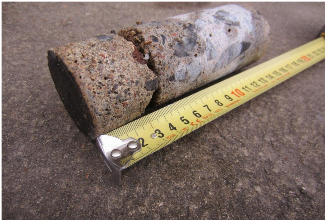
Kuva 26. Näyte PR15. Alapohja. Näyte ~135 mm pinnasta (tumma maali + betoni ~35 mm + betoni ~100 mm), näyte katkaistu. Alapohjarakenne näytteenottokohdassa ei selvinnyt porauksen päätyttyä. Näyte sisältää öljyhiilivetyjä C 10 -C 40 440 mg/kg.
