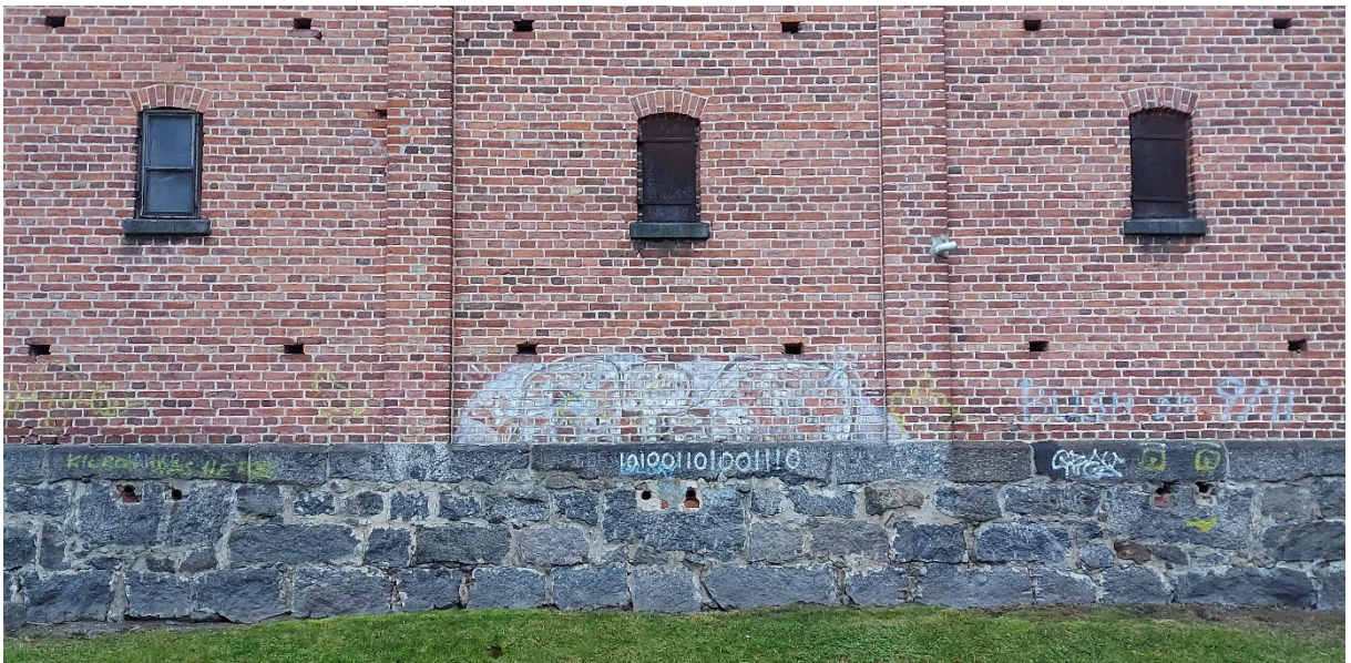
Kuva 63. Länsiseinällä on korkea kivijalka. Seinä on kärsinyt ilkvallasta.
