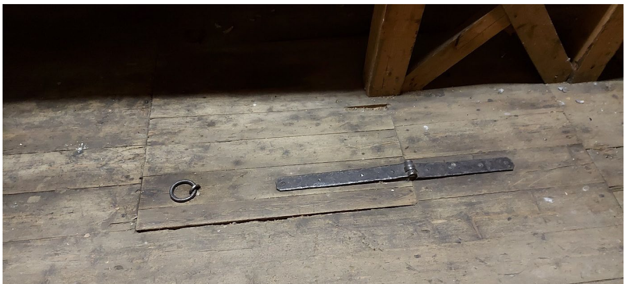
Kuva 27. Toisen kerroksen käytävään ullakolta johtava luiska on rakennettu osittain lattiassa olevan aukon päälle. Sitä ei myöskään näy alkuperäisissä piirustuksissa eli rakenne on tehty myöhemmin.
