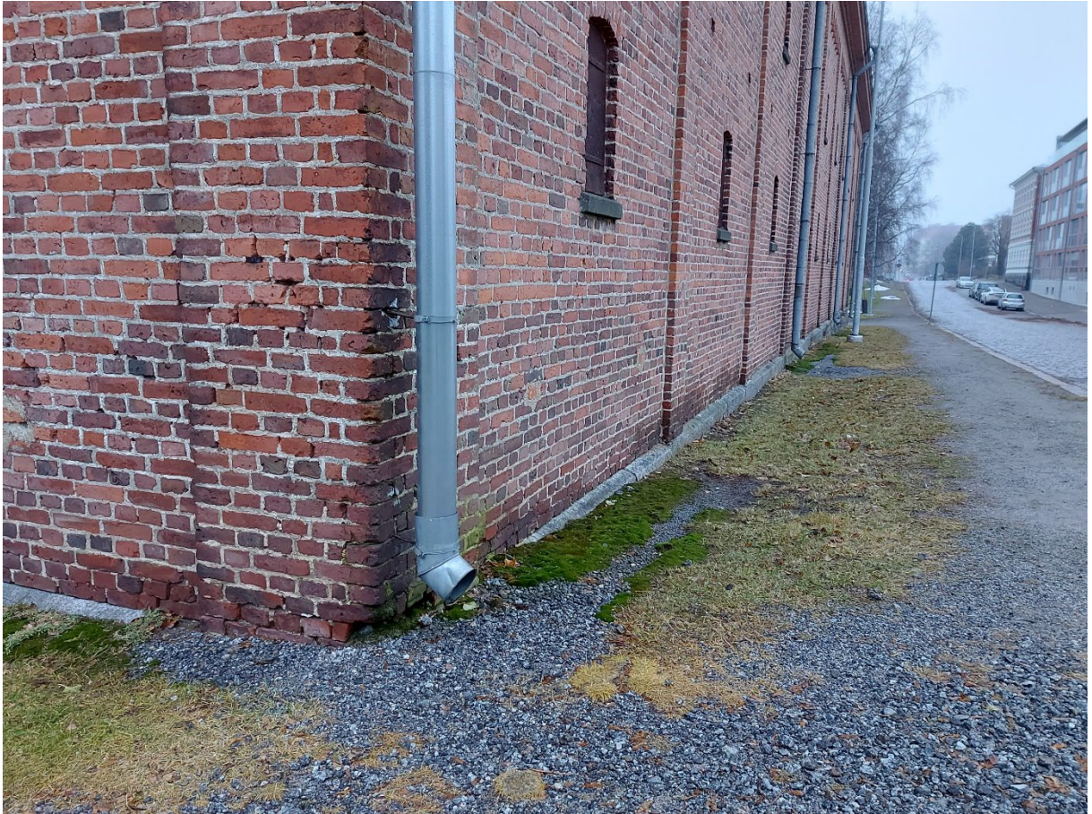
Kuva 62. Kaakkoisnurkassa kivijalkaa ei ole ollenkaan ja tiilirunko on kärsinyt kosteudesta. Rantakadun puolella kivijalka on muutenkin matalampi. Tässä nurkassa oleviin kahteen huoneeseen on valettu betonilattia 1980-luvulla alapohjan lahovaurioiden vuoksi.
