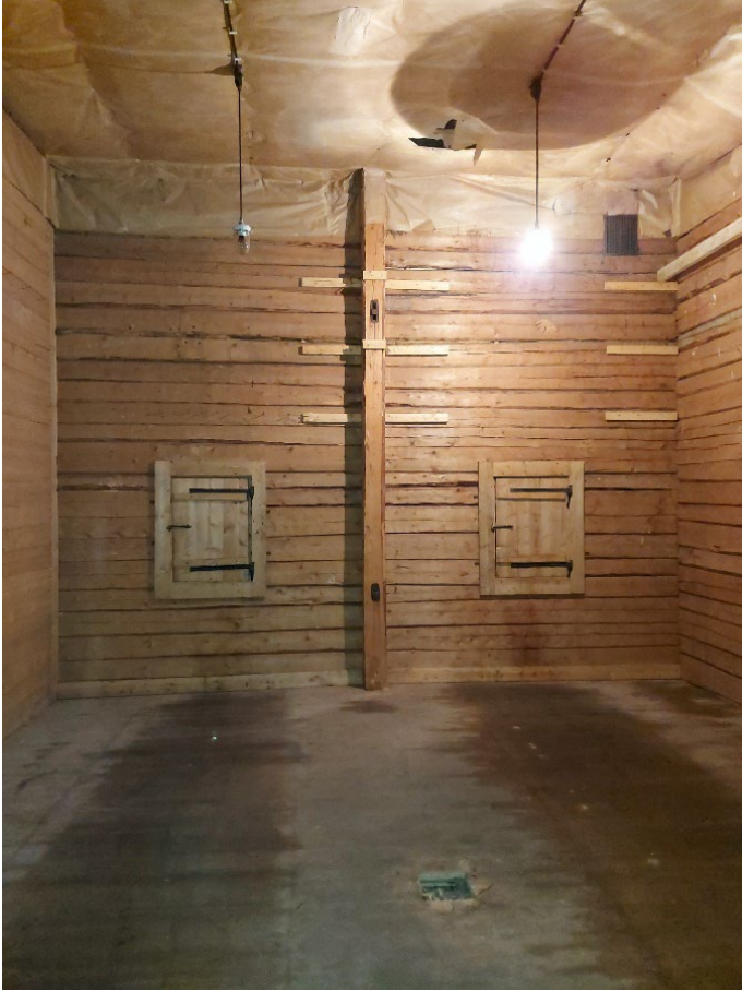
Kuva 79. Hirsikehikossa on puuluukkuja ulkoseinällä olevaan kapeaan tuuletuskäytävään.
