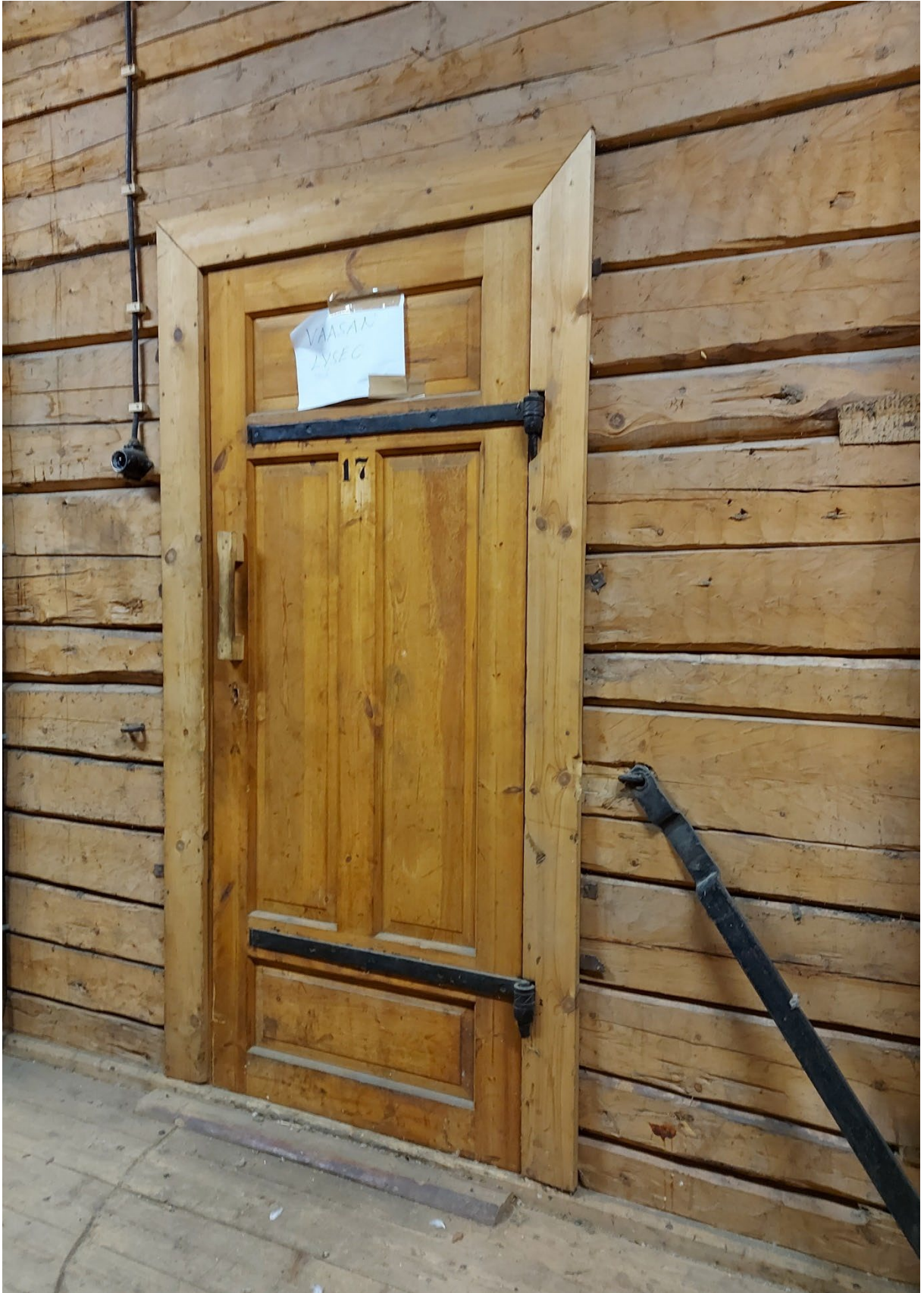
Kuva 28. Väliovet saranoineen ja salpoineen sopisivat kyllä 1800-luvun rakennukseen, mutta ne on todennäköisesti rakennettu vasta, kun rakennus siirtyi Puolustusvoimille. Oven kahvat ovat vielä myöhempää tekoa.
