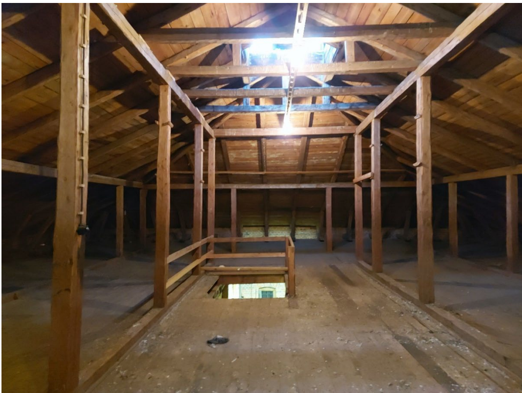
Kuva 82. Ullakko on yhtenäistä tilaa. Lattiasa olevasta aukosta voi nostaa painavia tavaroita ullakolle.
