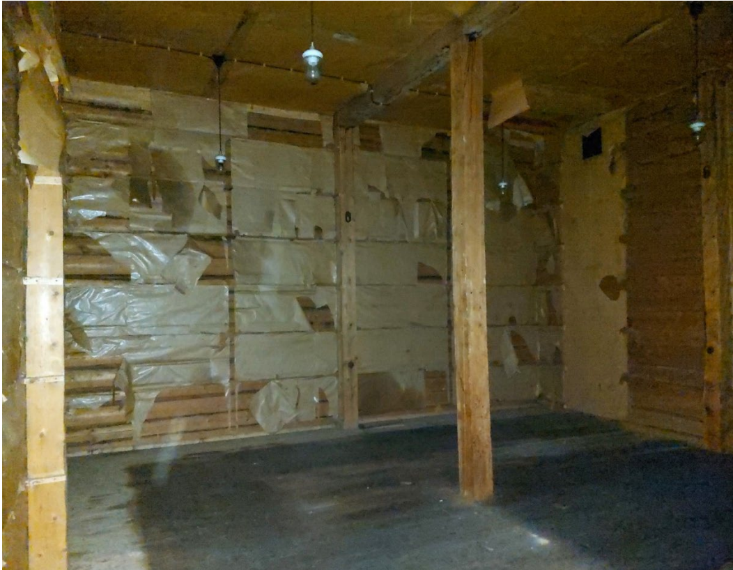
Kuva 70. Joidenkin huonetilojen seiniä ja kattoa on paperoitu/muovitettu.
